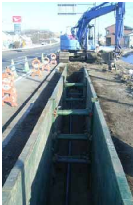
白浜町6号通り外配水管新設工事。白浜地区の国道44号変電所バス停付近から白浜町4号通りまで、未整備箇所配水管を新設しました。
