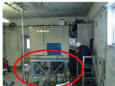
上水道取水ポンプ場非常用発電機嵩上げ後
