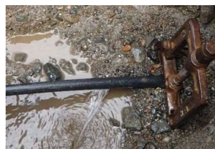
給水管漏水状況
