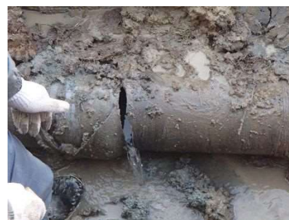
水道本管漏水状況
