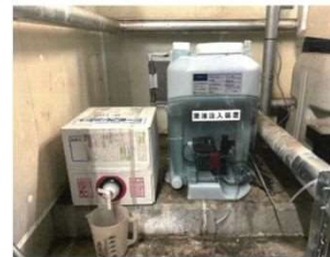
薬液注入装置 完 成
