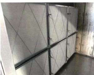
空調機NO1 フィルター室 完 成
