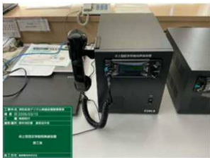
↑卓上型固定移動局無線装置 (通信指令室)
