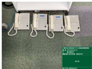
↑遠隔制御器(通信指令室)
