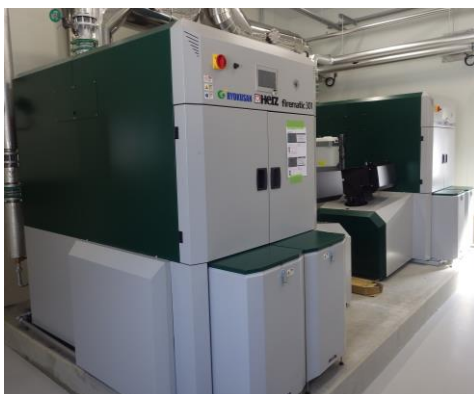
写真 II.3 木質バイオマスボイラー (厚岸町温水プール内)
