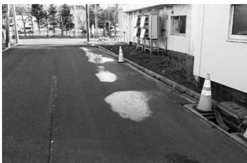
雨天に冠水する白浜5の通り
