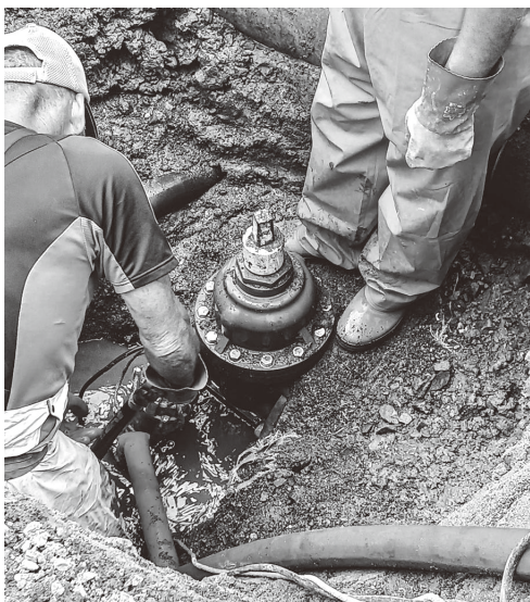
老朽化により破損した水道管
