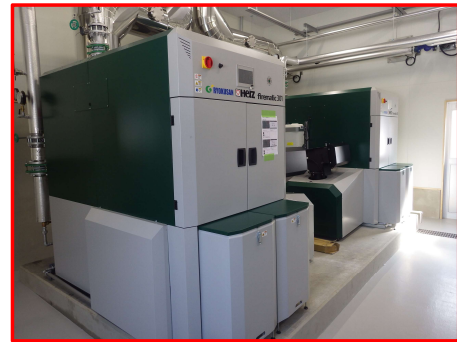
木質バイオマスボイラー (厚岸町温水プール)
