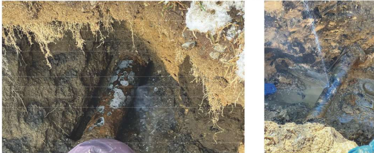
【破損した配水管の様子】
