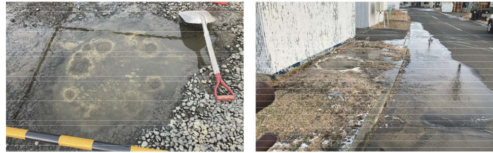
【配水管の老朽化により漏水が発生した様子】
