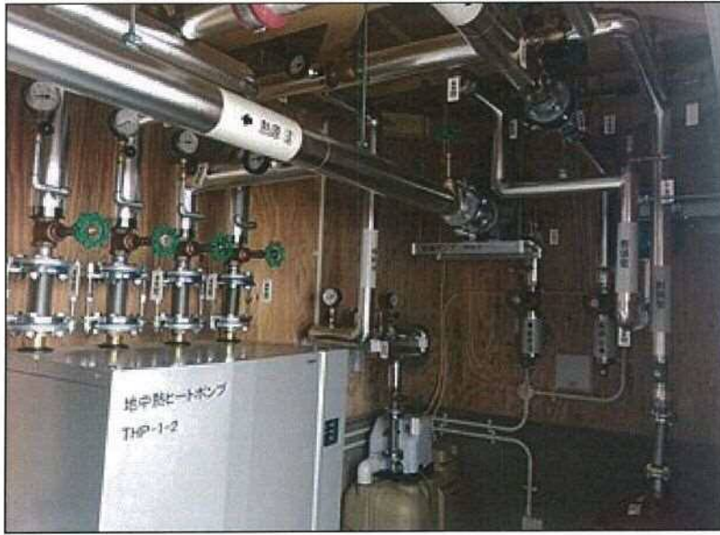
完了 機械室内
