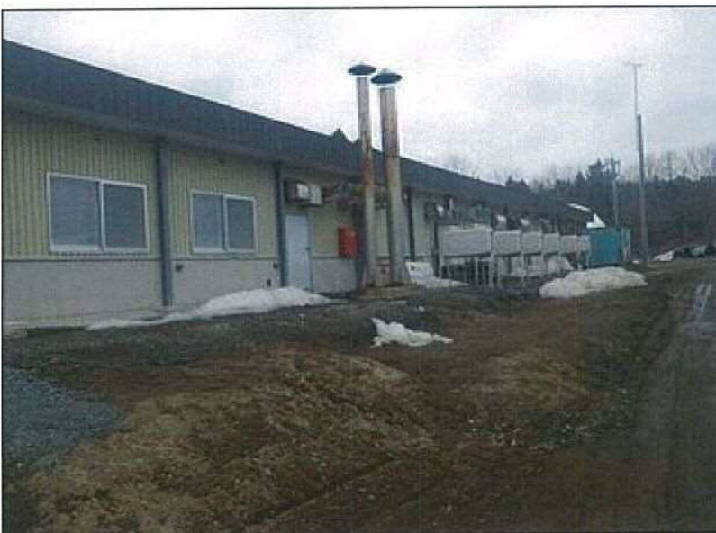
完了 熱源埋設配管
