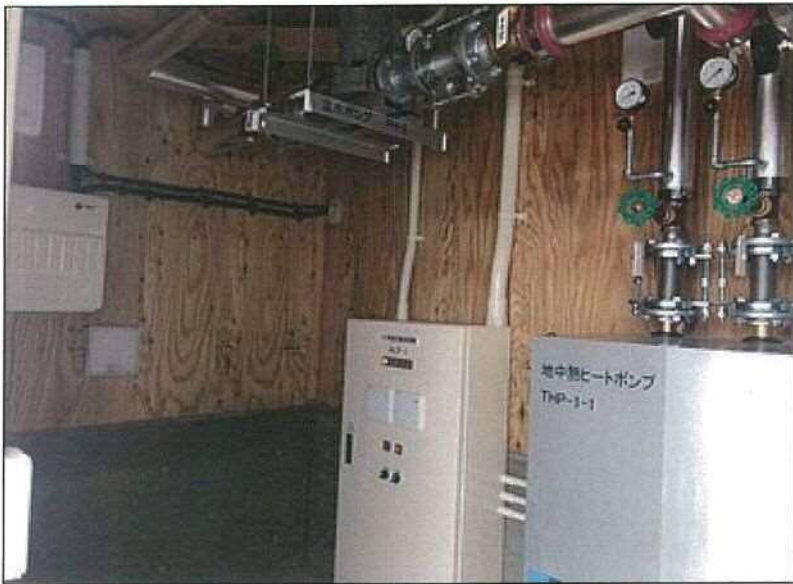
完了 機械室内
