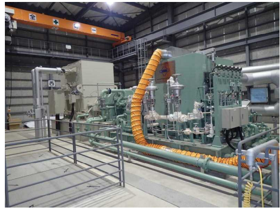
蒸気タービン・発電機
