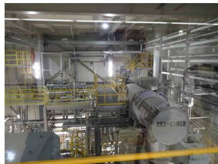
(ボイラー機器)
