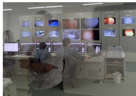
(中央制御室の様子)
